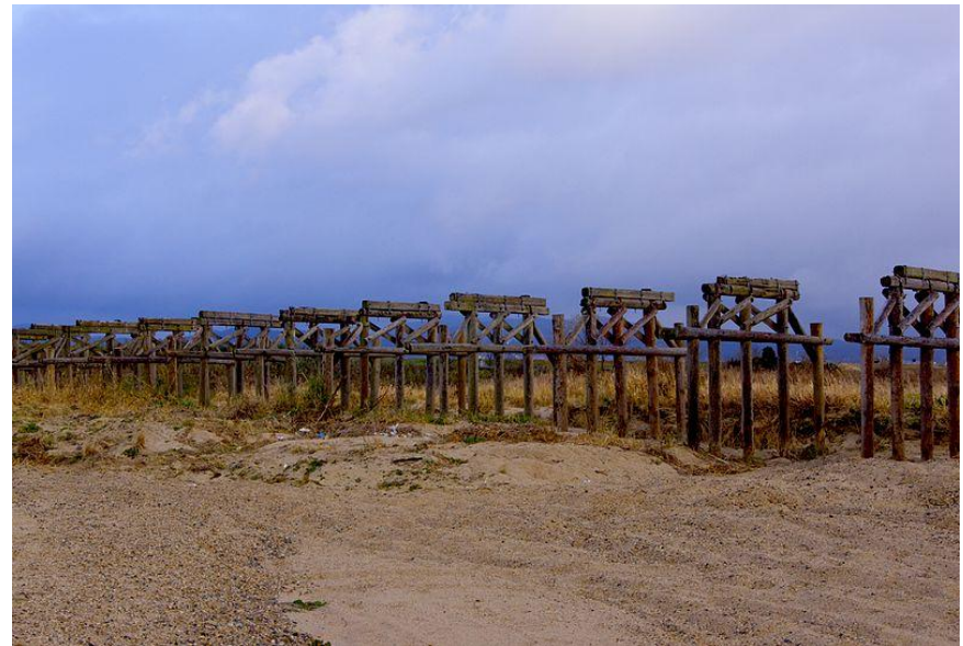
洪水によって橋桁が流された上津屋橋
