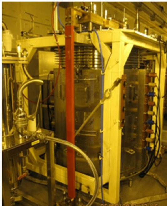
軽水炉酸化物燃料を 金属に還元する電界槽 (50Kg/バッチ)
