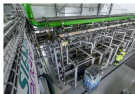
(出典) Siemens Energy社
