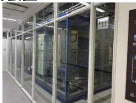
進工業(株)の小浜工場に導入した水電解装置(2024年6月) (出典) カナデビア(株)HP
