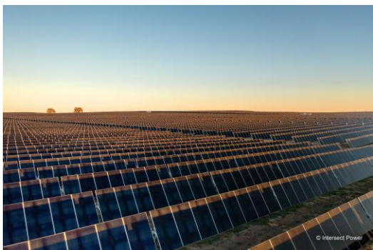
(出所) Intersect Power社HPより抜粋
