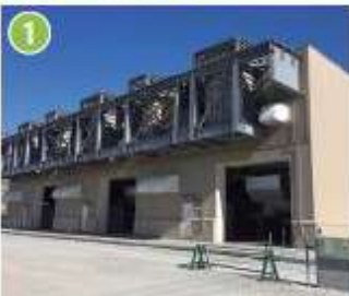
ガスタービン発電機建屋
