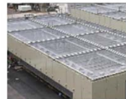
海水ポンプエリア飛来物防護壁
