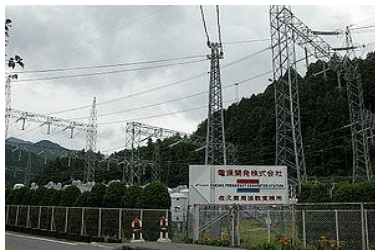
佐久間周波数変換所(変換能力30万kW)
