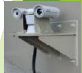
赤外線監視型津波監視カメラ
