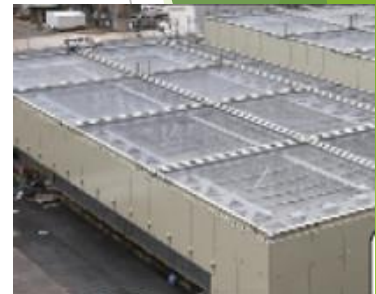
海水ポンプエリア飛来物防護壁
