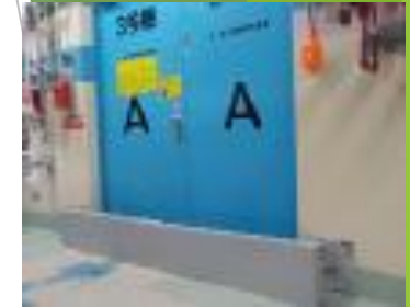
溢水防護区画(扉)への堰の設置
